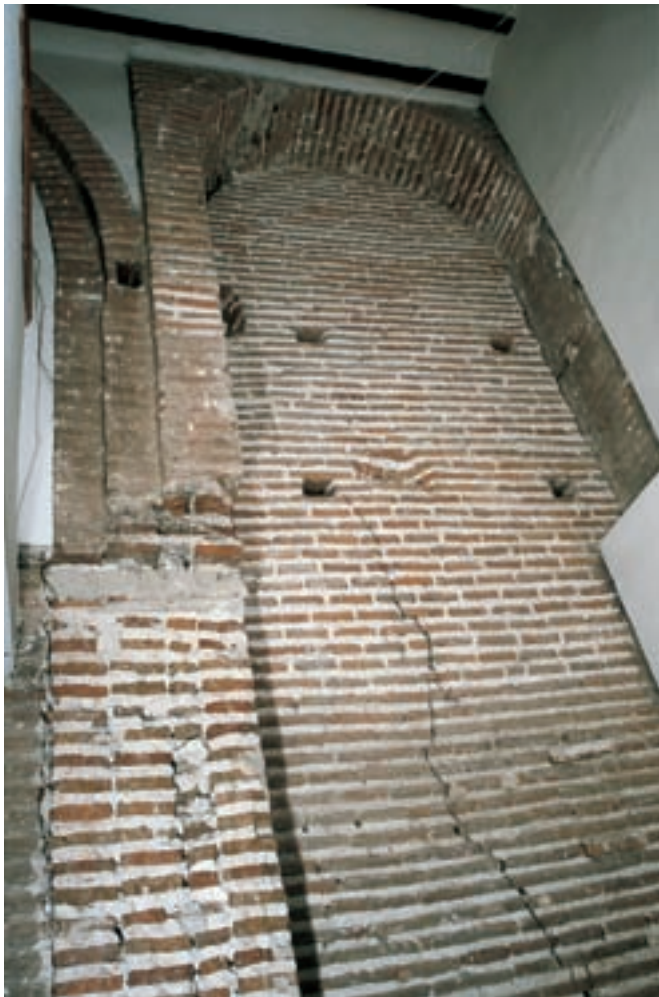
Fig. 17. Unión entre la torre y la arcada N de la iglesia. Muro N exterior [A100]. El muro de la derecha es el supuesto testero occidental de la iglesia
