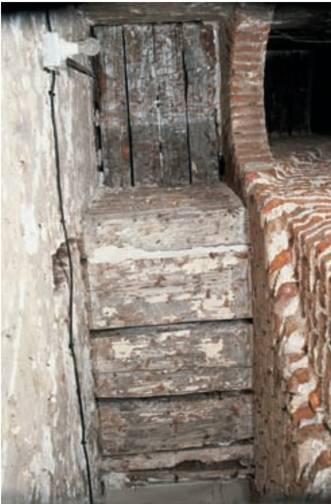
Fig. 5. Cubierta del primer tiro de la planta 1. a [A100]. A la izquierda el muro perimetral de calicanto con la ventana y a la derecha el muro de ladrillo del machón con el corte moderno [A105]
