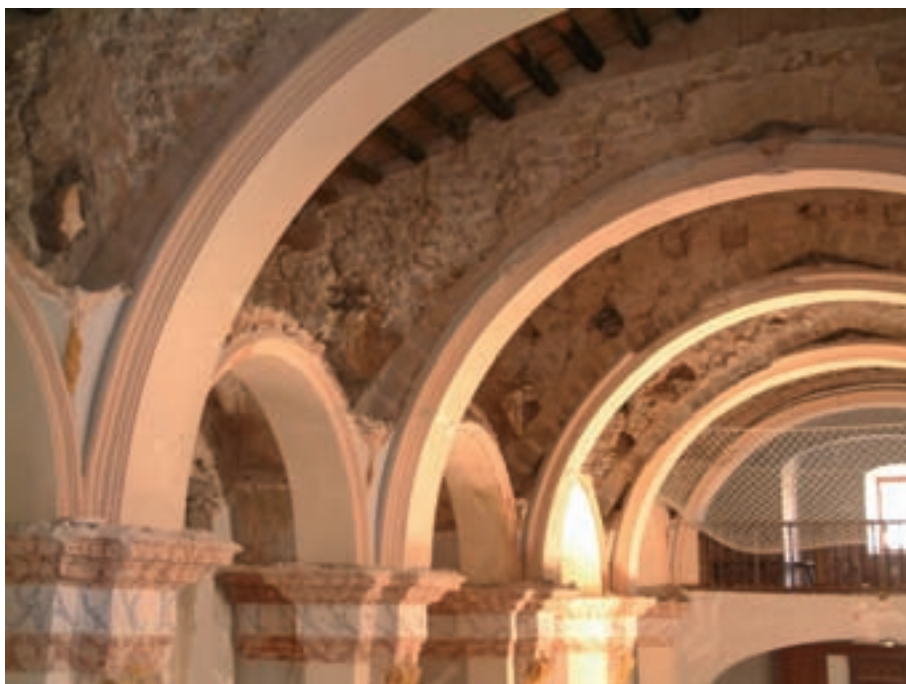
Fig. 2. Intervención de remoción de la fase barroca de la iglesia gótica de San Pere en San Mateu (Castellón)
