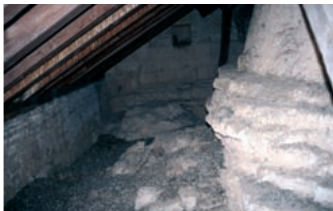
Detalle del extradós de la cúpula de la Capilla de Villaviciosa, estado actual
