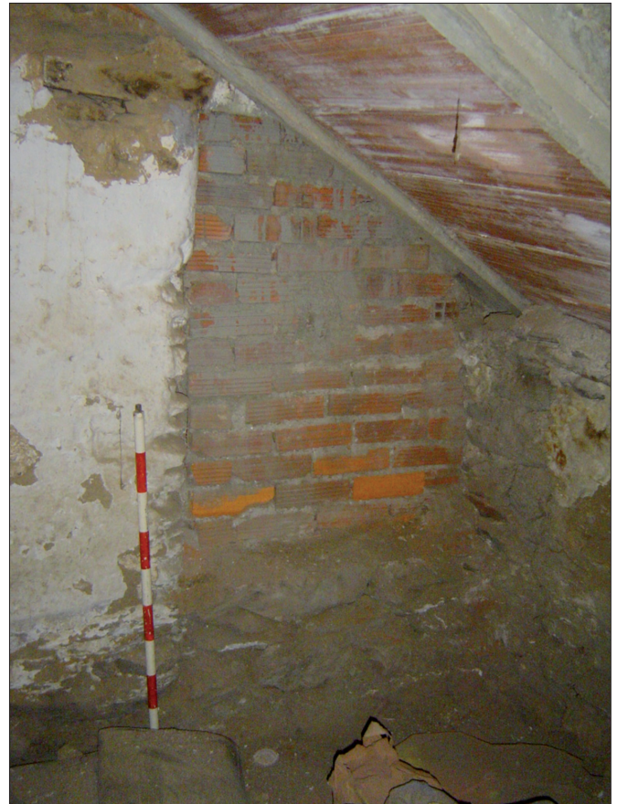
Fig. 15. Acceso original al patio interior en el muro interior E5 (UE 10502), amortizado por las obras de la escalera actual de acceso a la segunda planta (vista desde el sector I)
