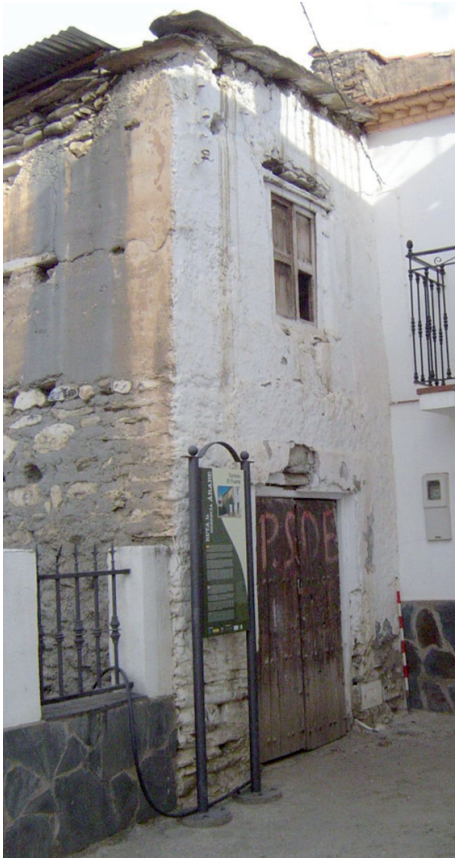
Fig. 13. Vista del muro perimetral este (E1). Pueden observarse algunas de las modificaciones sufridas a lo largo del tiempo (reducción de altura y colocación de nueva techumbre; apertura de puerta y ventana; adosamiento de otra vivienda; etc.)
