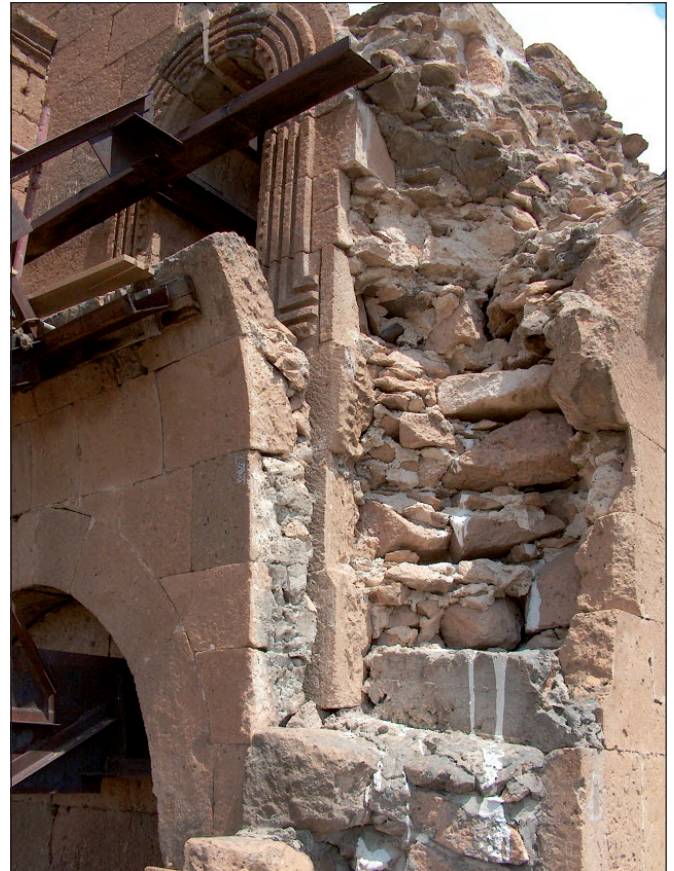
Fig. 20. Angolo sud-ovest della facciata, con sezione a vista della muratura del Periodo I, Fase 2 e Fase 3, ed il portico del Periodo II, Fase 5. Da ovest (Foto C. Tonghini)
