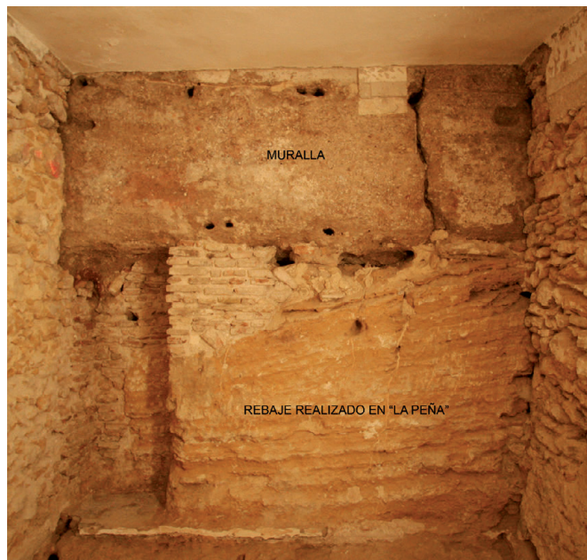
Fig. 12. Zona 2. Restos de la muralla sureste de Arcos de la Frontera aparecidos en el paramento este (muro A) del sector 4 de la casa de la calle Matrera Arriba nº 5, con la presencia de mechinales dobles
