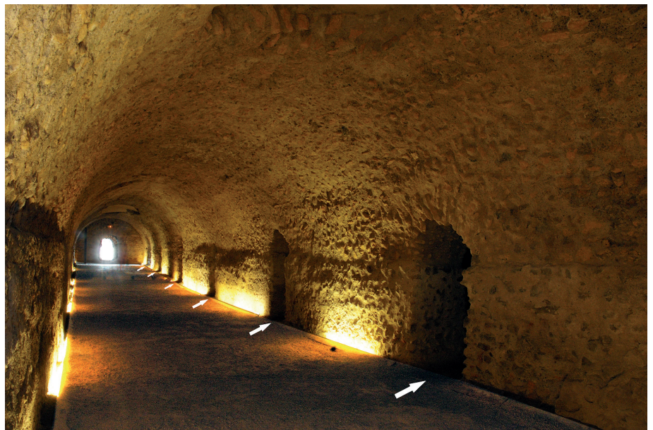
Figura 8. Vista de la volta llarga. A la derecha los accesos a las bóvedas perpendiculares y al fondo la puerta 3
