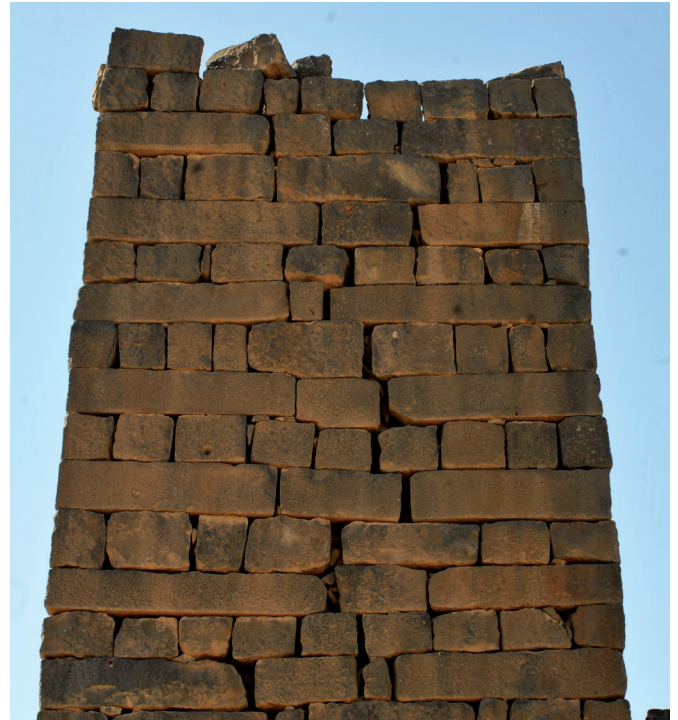
Fig. 32. Fronte settentrionale della torre-minareto del monastero di san Giorgio a Samā, particolare della muratura
