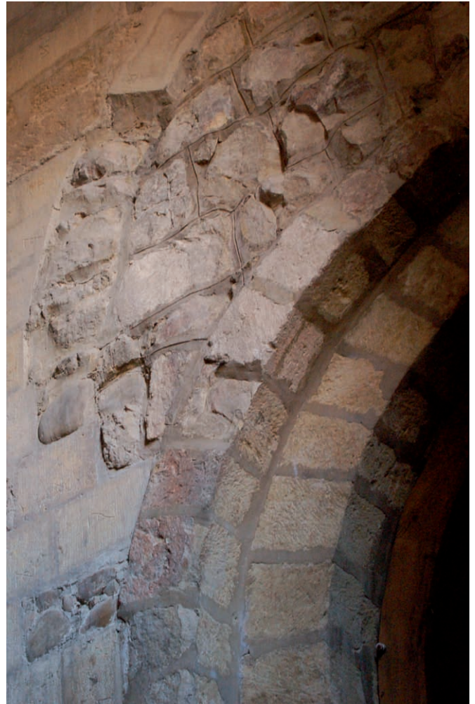
Fig. 10. Arranque meridional del arco superior [UE 1215, A 101] restaurado por J. C. Torbado [UE 1237, A 140]
