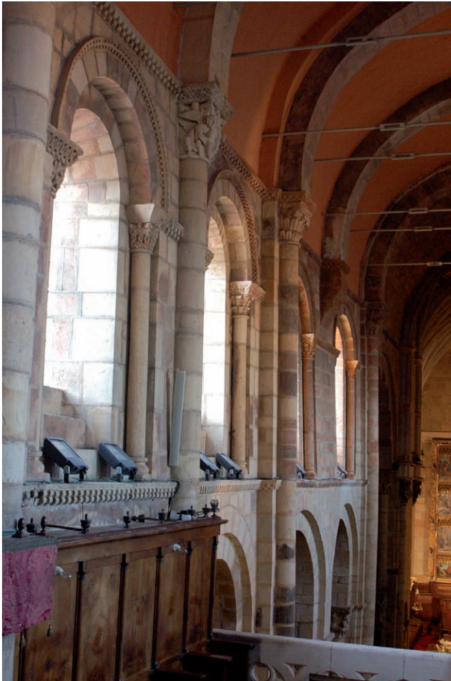
Fig. 40. Deformación [A 104] del muro norte de la nave mayor, con la segunda columna desde el este restaurada [UE 1150, A 109] y bóveda y arcos fajones en ladrillo [A 109] reparados
