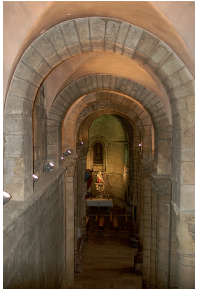
Fig. 42. Arcos de la nave septentrional en los que se aprecia su deformación, mostrando arranques rectos y tercios superiores reconstruidos [UE 1082, A 106]
