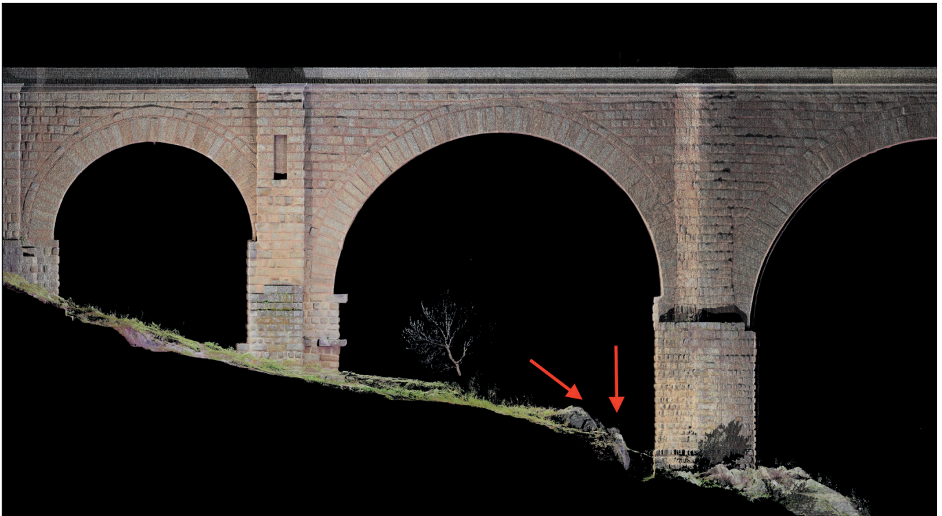
Fig. 16. Detalle de la zona del puente con el arco anterior e indicación del corte en el nivel geológico.
