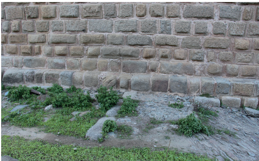
Fig. 15. Estructura en hormigón tipo plataforma con sillería central bajo la pila del puente de época de Trajano, en relación con la construcción del arco de la primera fase.
