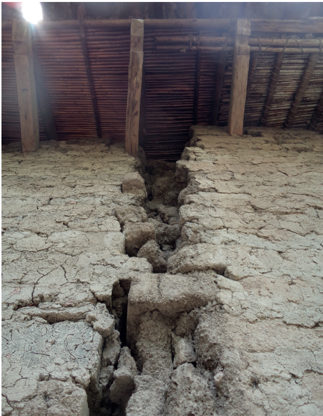
Figura 11. Grieta en el muro Sur. (Fotografía: Aguirre 2016)
