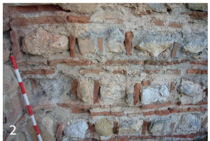
Figura 11. Puerta de Alfonso VIII o de Trascastillo, localizada al sur del conjunto amurallado de Fuentidueña, Segovia: 1) Vista general desde el exterior, donde se pueden ver los restos de mampostería encintada cajeadada conservados en su parte inferior; 2) Detalle de los restos de este aparejo localizados intramuros. Fotografías del autor (2014).
