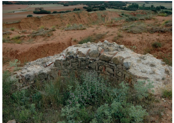
Figura 10. Restos de la fortificación de Fresno de Cantespino, realizados en mampostería encintada cajeadada. Fotografía de Gonzalo López-Muñiz (2009).
