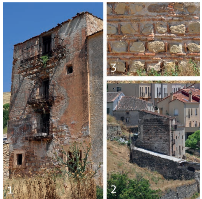
Figura 13. Torre de San Andrés de Sepúlveda: 1) Fachada sur de la torre; 2) Fachada oeste; 3) Detalle del aparejo de la torre en la base de la fachada sur. Fotografías del autor (2013).
