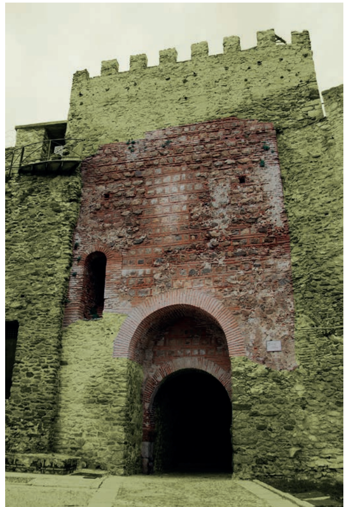
Figura 5. Vista general intramuros de la Puerta de la Villa de la muralla de Buitrago de Lozoya, indicando la fase altomedieval del paramento. Fotografía y composición del autor (2015).
