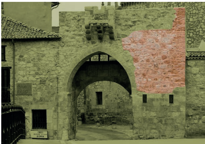
Figura 8. Fachada exterior del Arco de la Villa de la muralla de Ayllón, inmediata al cauce del río Aguijesejo tras su última restauración. Fotografía y composición del autor (2015).
