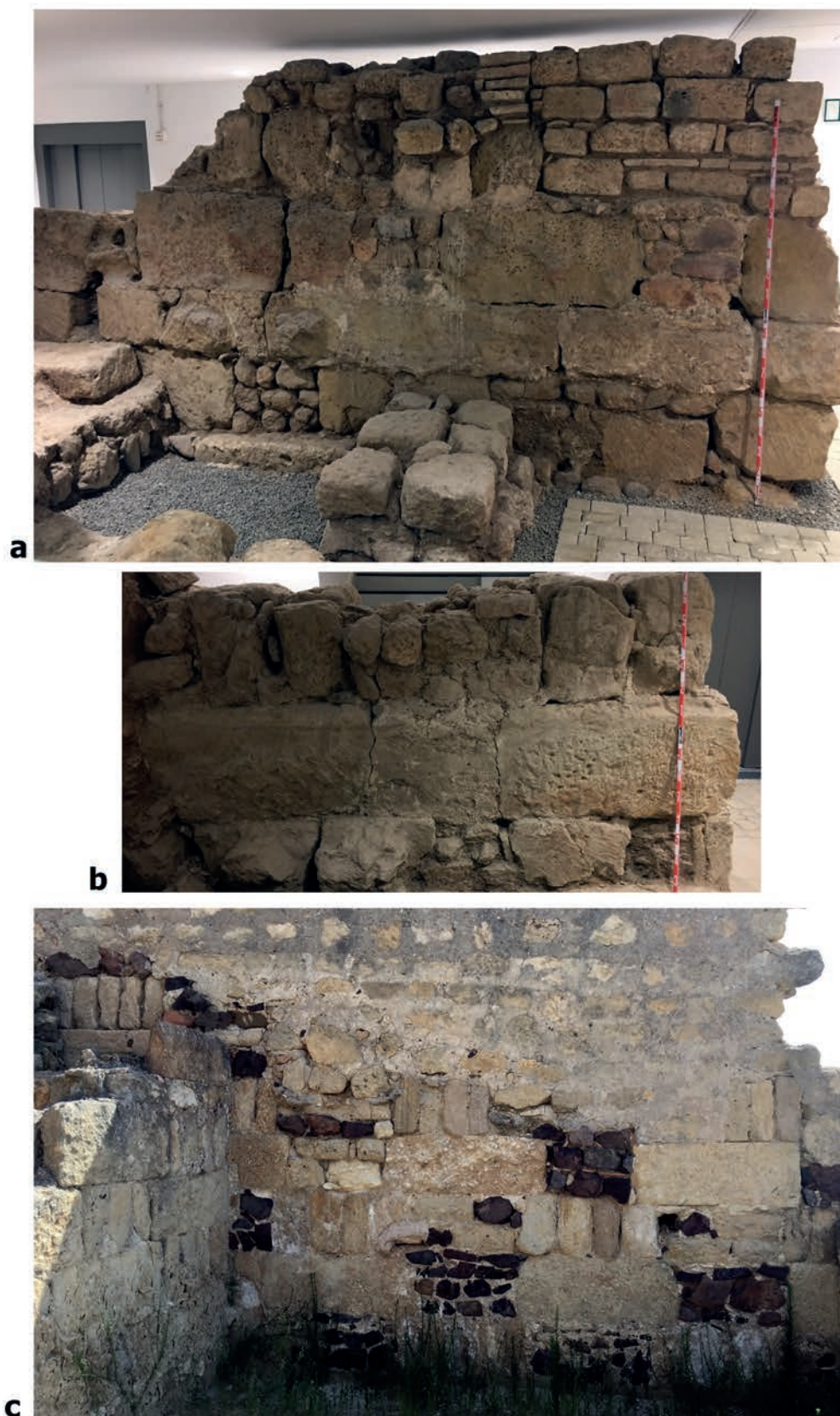
Figura 14. Aparejos en damero de época califal en Córdoba: a y b.- Centro de Arte Contemporáneo de la Fundación Botí (C/ Calle Manríquez, 5, junto a la Plaza Judá-Lévi) (fotografías del autor); c: Madinat al-Zahra (fotografía del autor).
