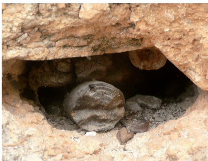
Figura 20. Media aguja rectangular dentro del tapial y conjunto de rollizos embebidos en la fábrica de la torre de Góntar, ubicadas en el punto donde el muro se escalona para cambiar de sección. Fuente: autor.
