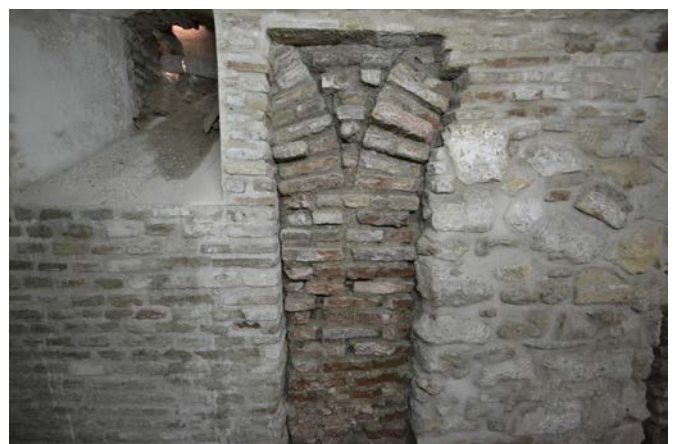
Figura 29. Restos de la arquería del patio islámico enmascarada tras uno de los muros del sótano.
