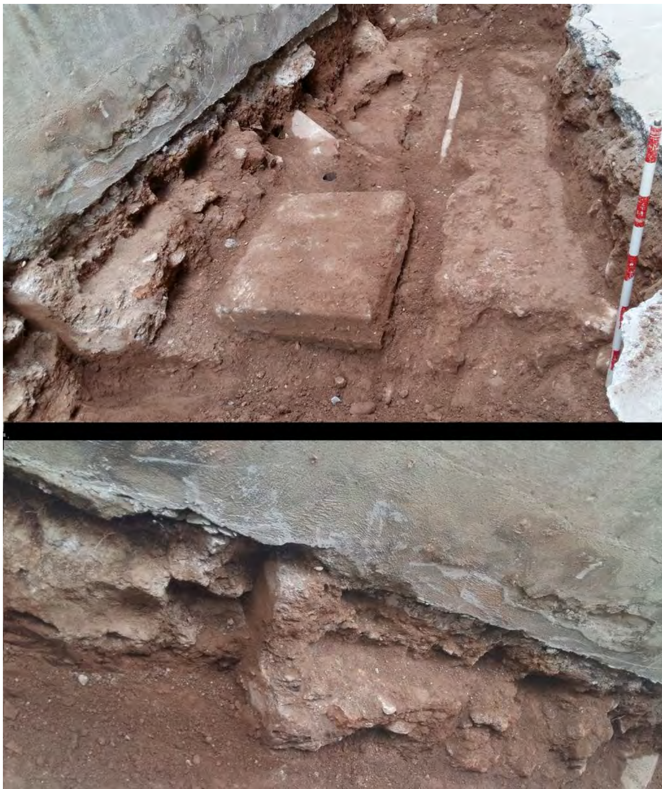
Figura 15. (1) Cimentación de la torre de la calle Zaragoza. (2) Detalle del paramento del encofrado de la cimentación de la torre bajo las casas. Fotografía: autores.
