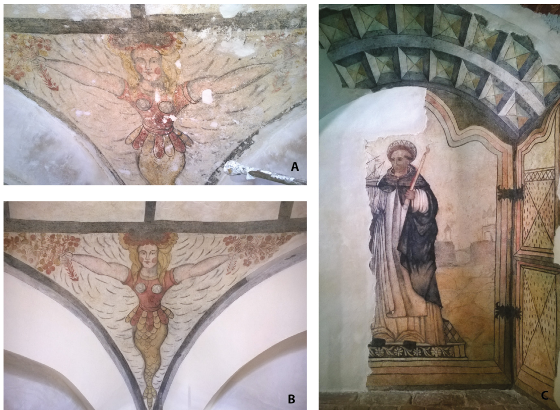
Figura 24. Detalle de frescos restaurados; A: sirena descubierta en la Capilla del Rosario; B: pintura luego de su restauración; C: pintura restaurada de San Telmo, patrono de los marineros, muro norte del transepto.
