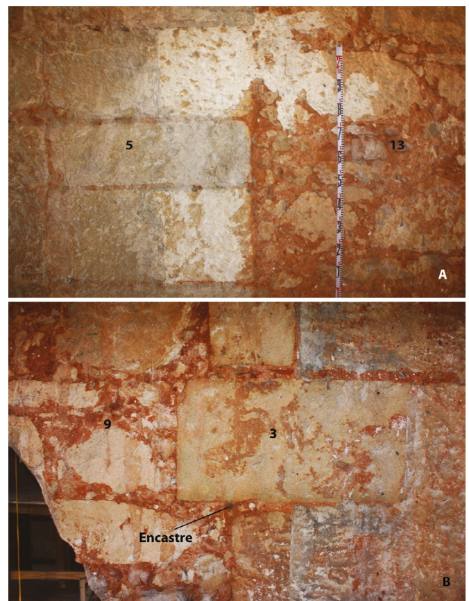
Figura 20. Sistemas de adosamiento entre la iglesia gótica y la nave central; A: adosamiento simple entre muros Tipo 4 (izquierda) y Tipo 6 (derecha), muro sur. B: adosamiento encastrado entre muros Tipo 6 (izquierda) y Tipo 4 (derecha).
