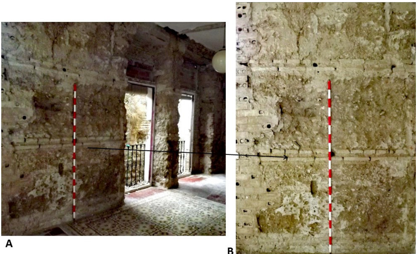
Figura 16. Tapial del Tipo 5.1 documentado en Encarnación 4. A. Detalle del paramento. B. Detalle de los agujales.
