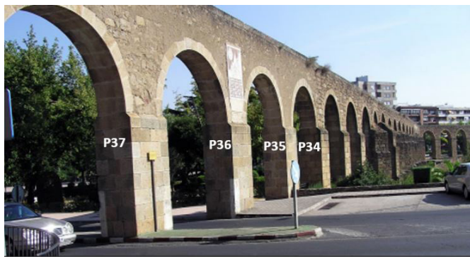
Figura 14. Pilares tipo 7, atravesados por la carretera de la avenida Salamanca. Fuente: elaboración propia (2021).
