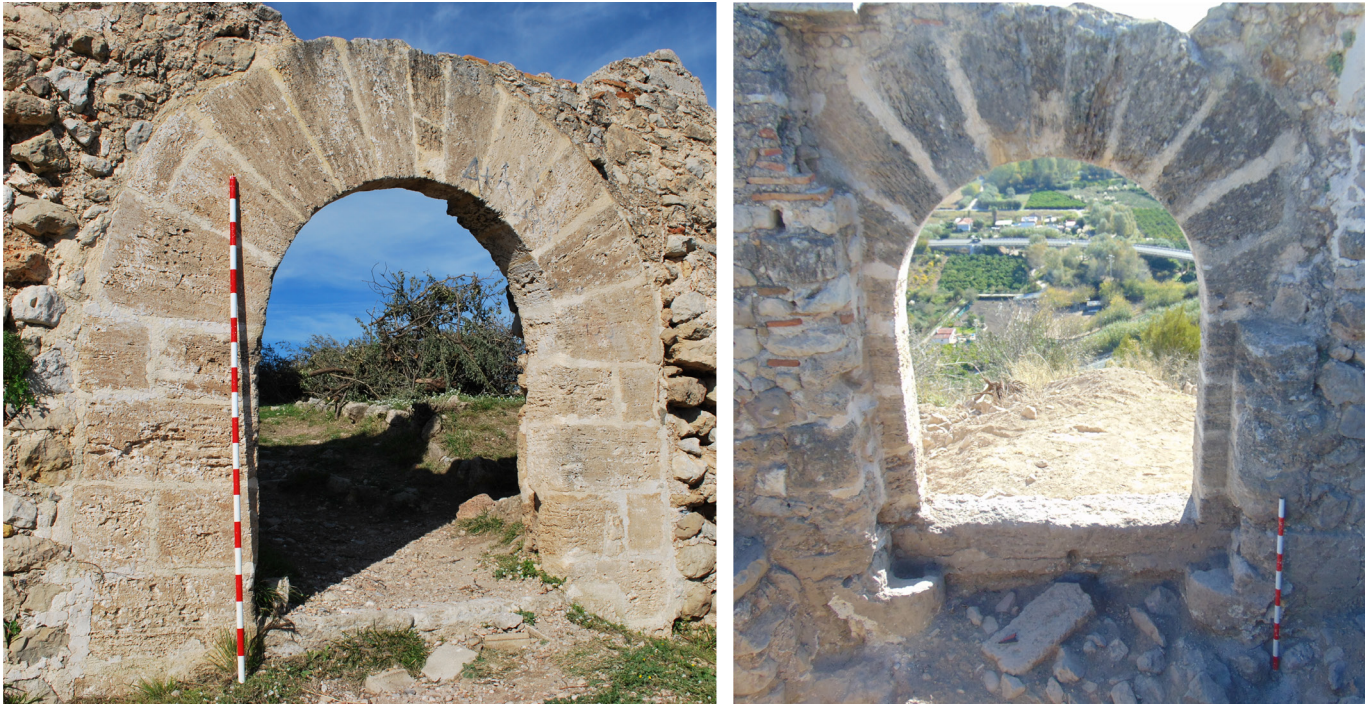
Figura 4. Sistema constructivo mediante sillería trabada con mortero (S1). Imagen de autoría propia.
