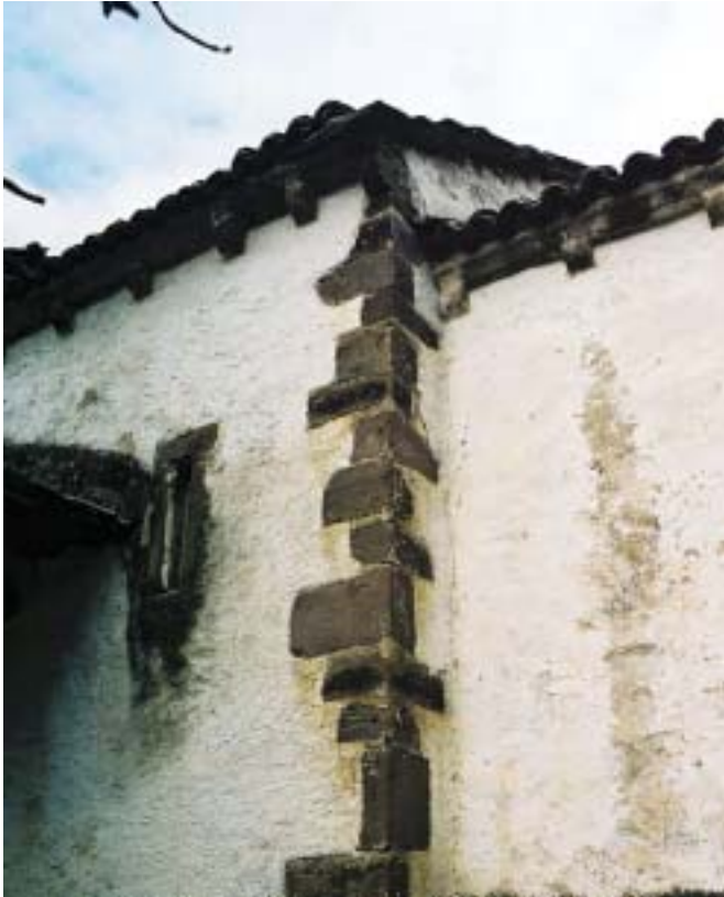
Fig. 4. San Vicente de Naviegu, siglo XIII. El entronque entre la nave y el tramo recto del presbiterio se refuerza con sillares de distintas dimensiones colocados alternado la disposición a soga y a tizón, como elemento de refuerzo estructural del edificio. El aparejo de la construcción es mampostería de caliza enripiada
