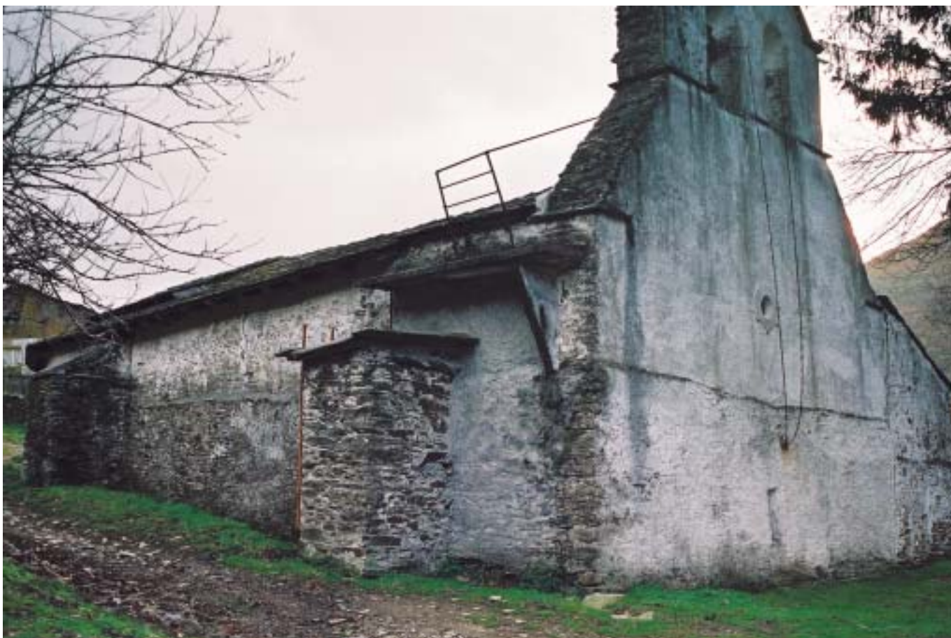
Fig. 7. Santa María de Vil.lacibrán. Siglo XIII. Construcción realizada con mampostería de pizarra
