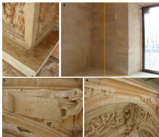
Figura 11.1. Talla a trinchante en el arquitrabe de la entrecalle derecha de la portada (s. XVI). 2. Unión de las fábricas del siglo XVI y XVIII en el paramento interior de la fachada, junto a la jamba del balcón de la portada. 3. Refacción en la unión entre las enjutas, rosca del arco y el dintel de la portada. La junta engrosa progresivamente desde los medallones que decoran las enjutas hacia la clave, debido al desplazamiento del despiece de la sillería. 4. Como resultado, en la clave ha sido necesario introducir una pieza estrecha entre la rosca y el dintel, de modo que no hay contacto entre ambos elementos.
