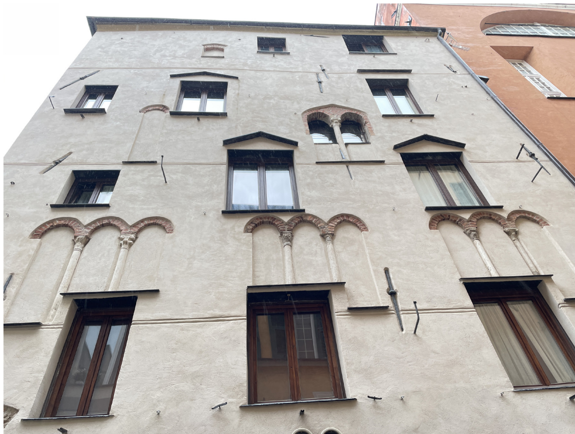
Figura 2. Genova, edificio in via di Mascherona. Un esempio di intervento che segue la logica del "palinsesto di segni": si è privilegiata la valorizzazione di elementi puntuali, segni significativi che vanno a rompere l'unità preesistente della facciata ma non si configurano come strato immediatamente comprensibile, richiedendo un processo interpretativo. I segni sono citazioni all'interno di una narrazione. La configurazione più recente, al contrario, è stata silenziata e trattata come una "tinta neutra": nessun marcapiano, eliminazione delle persiane e una colorazione dell'intonaco uniforme e spenta in netto contrasto con il contesto urbano. Autore Lucina Napoleone.
