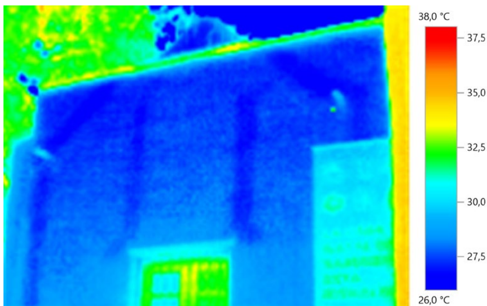
Figura 10. Termografía de la fachada de la Sala Natal que muestra parte de la ventana que da a la calle y la superficie del muro que se extiende por encima. La madera y el vidrio de la abertura aparecen en color verde y amarillo y dan cuenta de una temperatura más elevada que la de la superficie muraria, coloreada en celeste. La escasa radiación emitida por dos elementos verticales ubicados encima de la ventana y a su izquierda, visibles como rasgos azul oscuro, revelan la presencia de columnas de hormigón armado. Fuente: elaboración propia.
