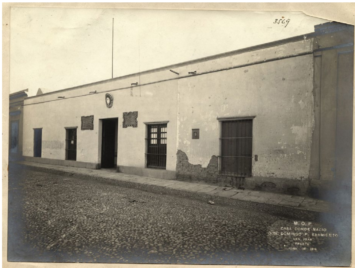
Figura 5. Fotografía del edificio del año 1916 en que se observa una marcada diferencia en la conservación del sector norte y la del sector sur de la fachada. Fuente: fotografía del CeDIAP.
