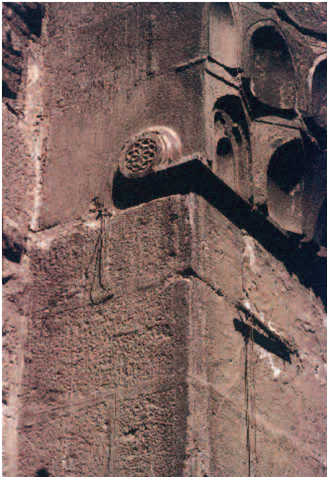
Figure 18. Angle de la Tour T 07 et de la courtine C 06 à hauteur du muqarnas de la porte avant restauration (cliché A. Hartmann-Virnich, 2002)
