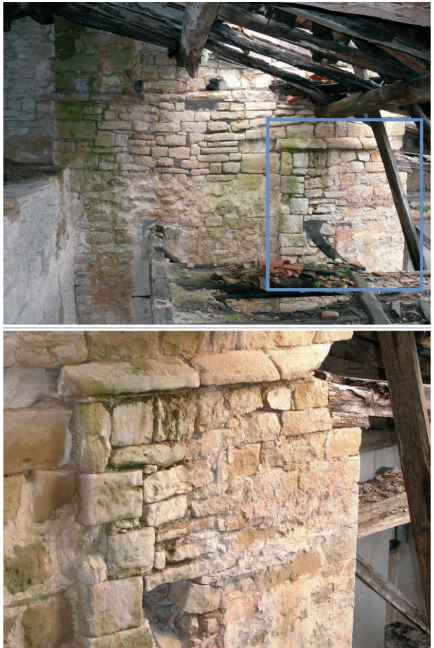
Fig. 8. Remate de la espadaña exenta al sur de la iglesia (UE 77), enmascarada por la espadaña románica y las obras posteriores. En la imagen superior, aspecto general del muro; en la inferior, detalle de la UE 77. El reducido espacio donde se ubica nos impide obtener imágenes en las que se aprecie la espadaña completa
